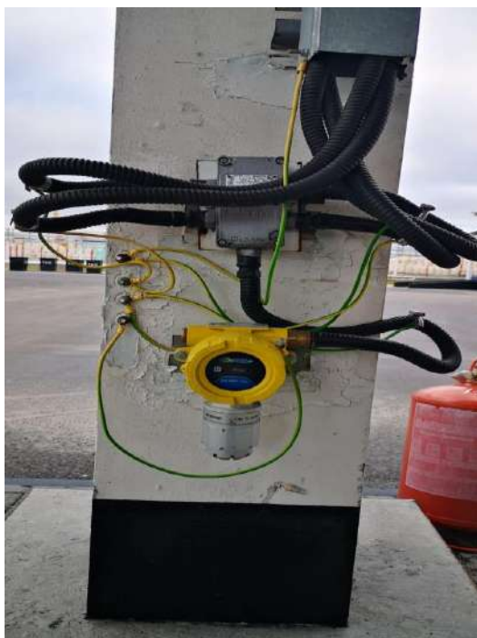
Рисунок 43 В технологических колодцах резервуаров блочных АЗС установлены датчики дозрывных концентраций
