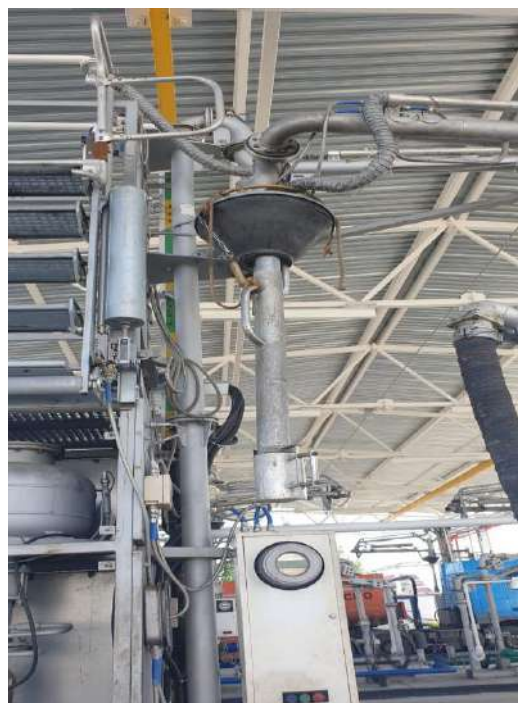
Рисунок 44 Оснащение автоматизированных систем налива нефтебаз телескопическими наконечниками
