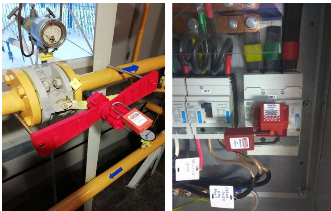
Рисунок 25 Блокирующие устройства на запорной арматуре и автоматических выключателях
