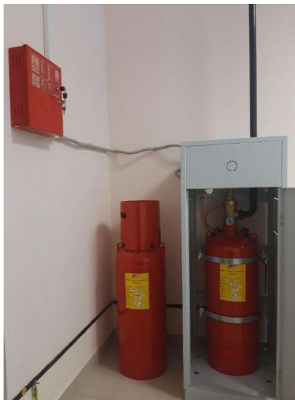
Рисунок 26 Система газового пожаротушения в помещении серверной АБК
